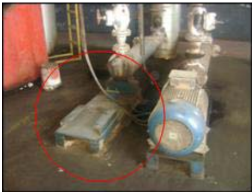
Foto 1: Obsérvese la ausencia de una bomba de respaldo
