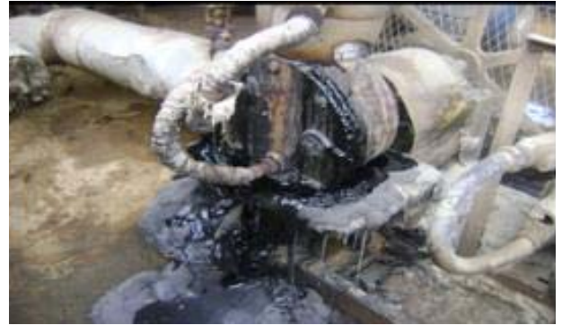
Foto 2: Bomba con necesidad empaque
