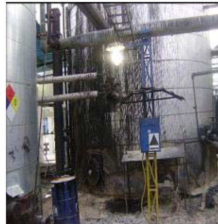
Foto 3: Derrame de asfalto corregido que no fue recuperada la visual externa del tanque
